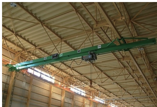
図 6.3 クレーン走行梁（写真とは異なるが、工場 1 にもある）
