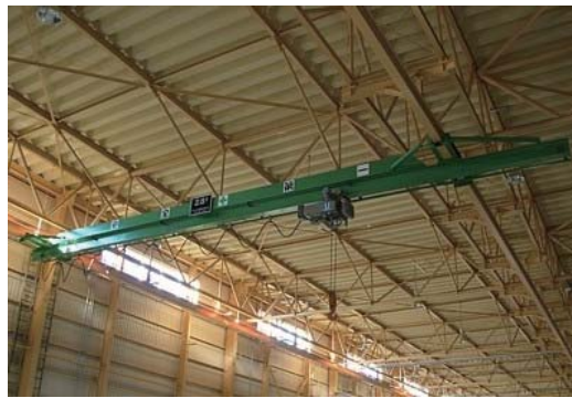
図 6.3 クレーン走行梁（写真とは異なるが、工場 1 にもある）
